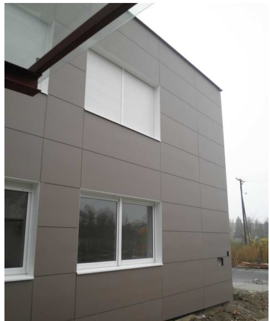
Dom zdravlja, Osijek – Levantina ploče 3 x 1 m na Bostik ljepilu i BWM potkonstrukciji ATK 100
