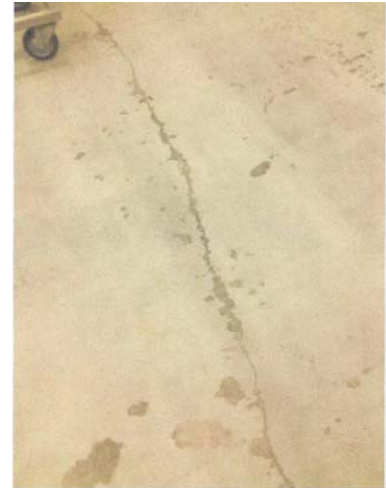
Pukotine u betonu
